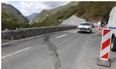
C'est une fissure comme celle-là qui a donné l'alerte. La route risquait de s'effondrer sous le poids des camions ( photo BAP)
